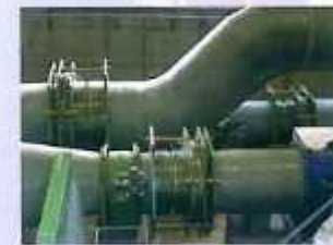
اتصال انساطی فلزی نوع پرشر بالانس محوری سایز: ۵۶ اینچ - پروژه: نیروگاه بخار سهند شیراز
